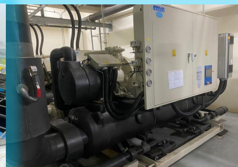
增設變頻式冰水主機
