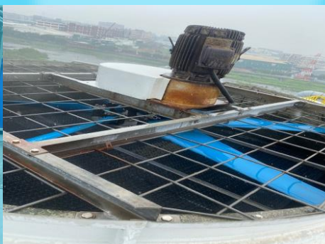
冷卻水塔節能風扇
