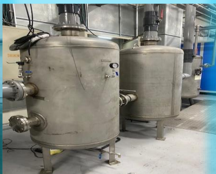
增設空壓系統儲槽
